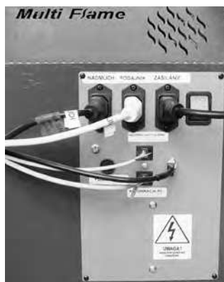
Rysunek 3 Moduł sterujący pracą palnika. (Przykładowy wygląd listwy w zależności od modelu sterownika zamontowanego na kotle)
