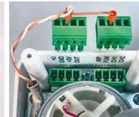
Фото 18. Подключение проводного выключателя к электроприводу
