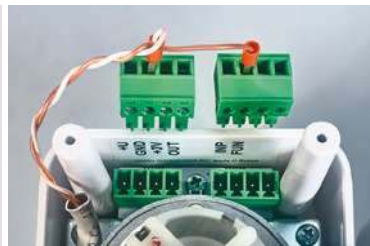
Фото 23. Подключение проводного выключателя
