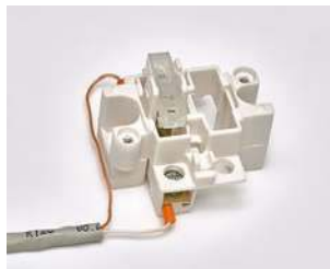
Фото 22. Подключение проводного выключателя
