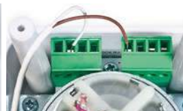
Фото 15. Подключение датчика к электроприводу
