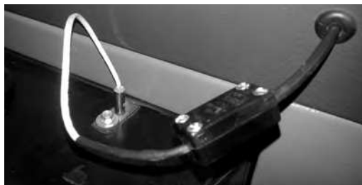
Rysunek 4 Czujnik temperatury spalin zamontowany w czopuchu
