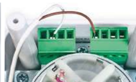
Фото 15. Подключение датчика к электроприводу
