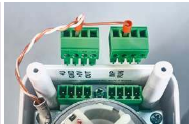
Фото 23. Подключение проводного выключателя
