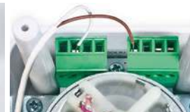
Фото 15. Подключение датчика к электроприводу
