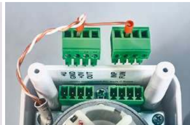
Фото 23. Подключение проводного выключателя
